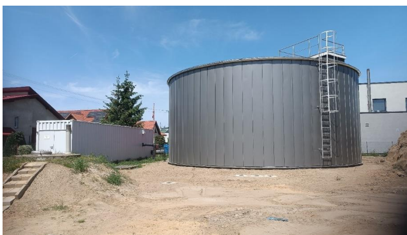
Zdjęcie nr 2: Zbiornik do gromadzenia wody uzdatnionej – stacja uzdatniania wody w Lipnie.
