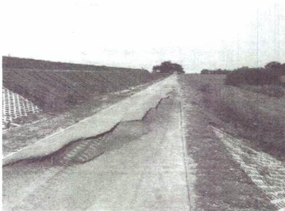
Fot. 2: Uszkodzona ścieżka pieszo-rowerowa: widok w kierunku Osiecznej (sierpień 2023r.)
