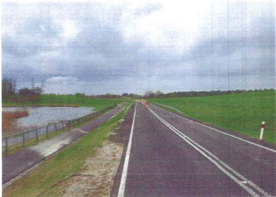
Fot. 5 Widok ogólny na uszkodzony odcinek drogi powiatowej (widok w kierunku Goniembic)
