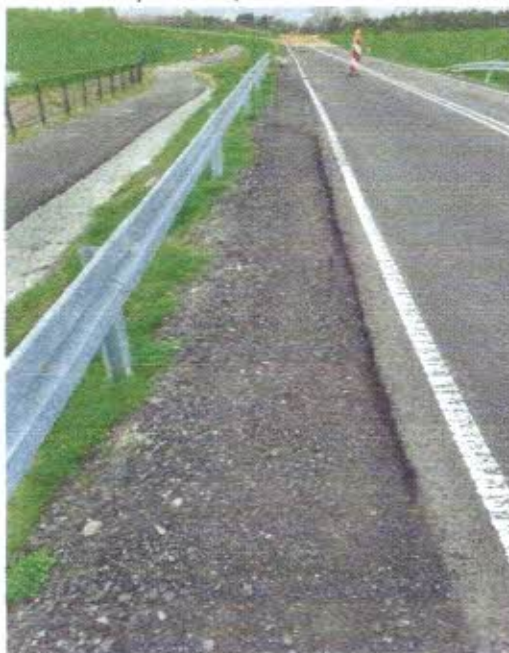
Fot. 9: Osiadanie pobocza (widok w kierunku Goniembic)
